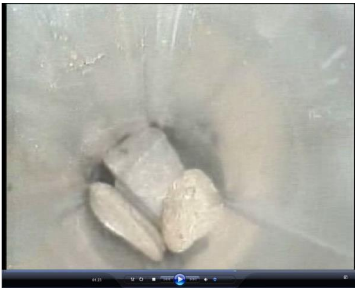
Fig.5 - Occlusione della tubazione inclinometrica 2I alla profondità di 6m – telecamera da foro
