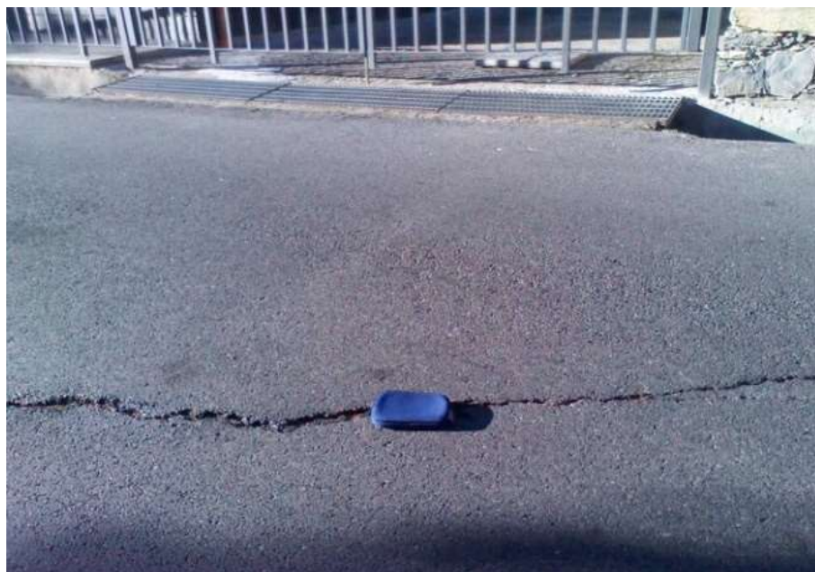
Fig. 13 - Fessure di trazione nell'asfalto in evoluzione nel mese di dicembre 2015.
