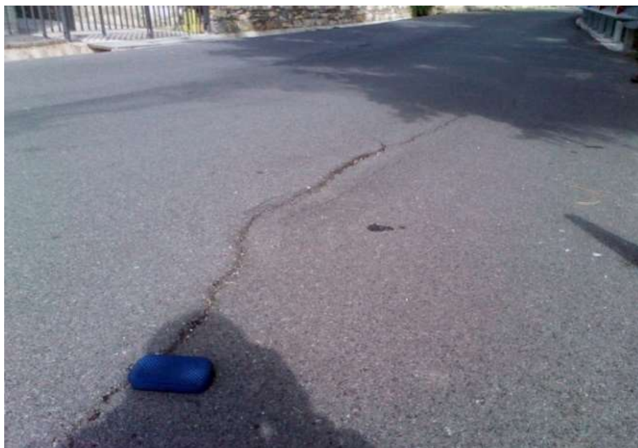
Fig. 12 - Fessure di trazione nell'asfalto in evoluzione nel settembre 2015.
