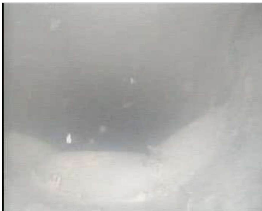
Fig. 5 - Inclinometro S2. Nella foto si può osservare la presenza dello scalino a -21.90 m di profondità, risultato della deformazione in atto, che rende pertanto la tubazione non più utilizzabile (videoispezione del 30/04/2015).
