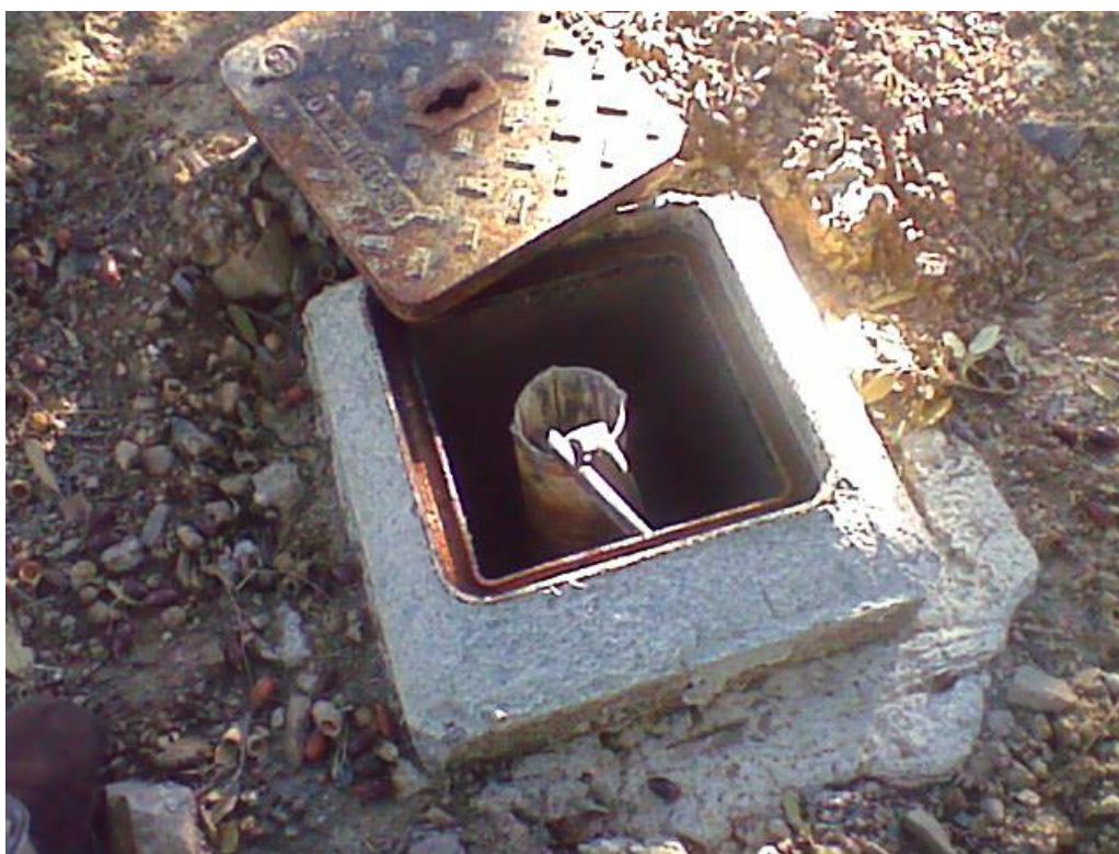
Fig.20 - Pozzetto del tubo inclinometrico installato in "zona S15"
