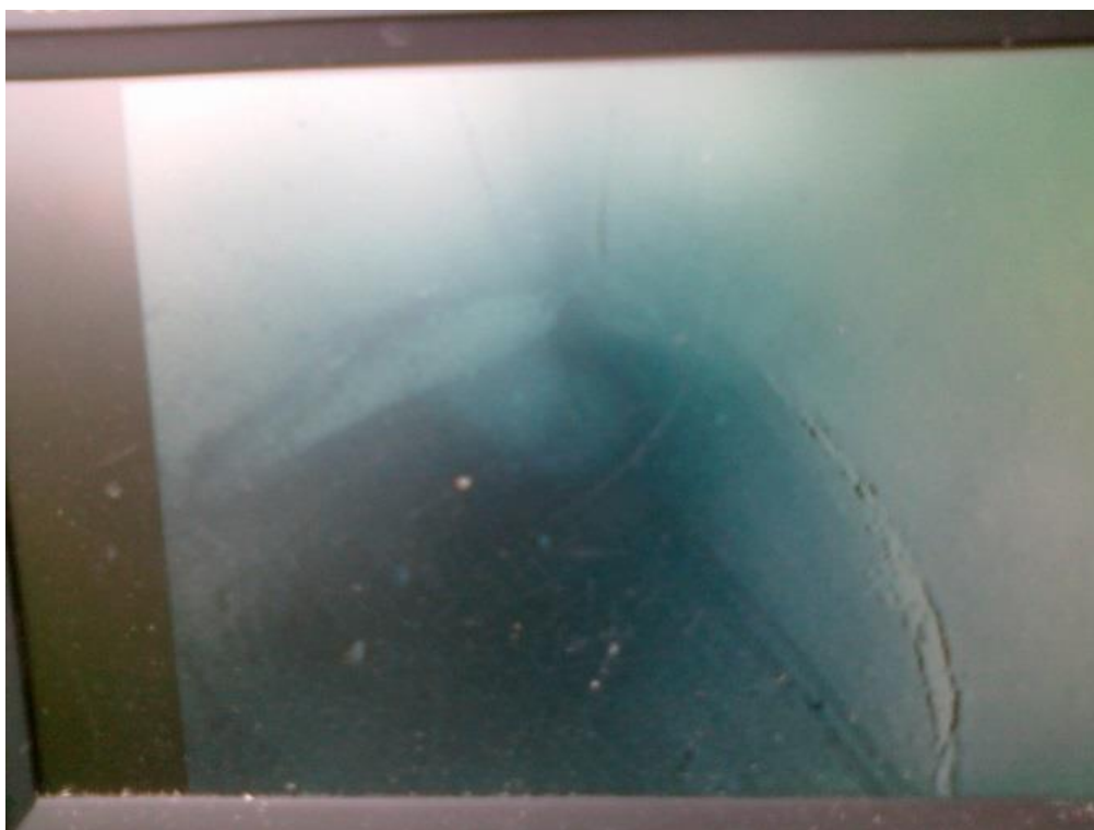
Fig. 5a - Ispezione televisiva: piani di taglio alle profondità di -13.40 m nell'inclinometro d.
